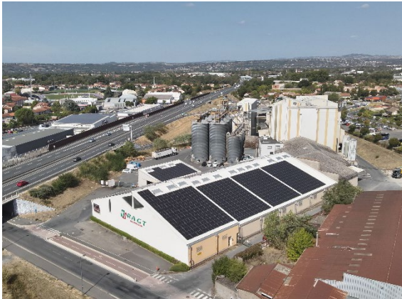
La centrale photovoltaïque du site d'Albi
